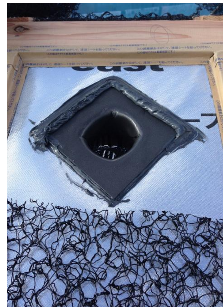
集熱ダクト入り口
